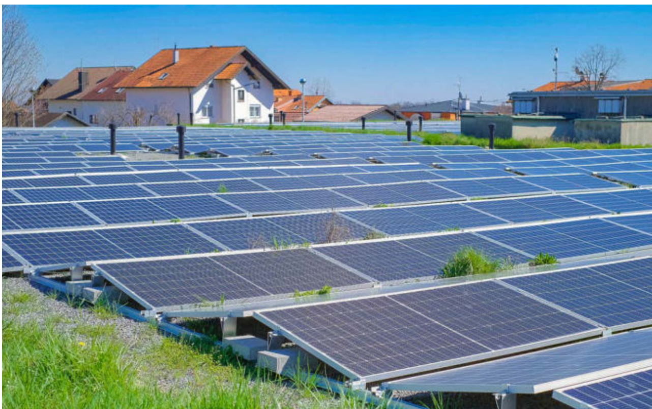
Solarna elektrana na vodospremi Bukovac tvrtke ViO.
